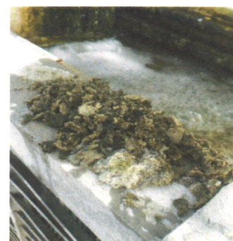
除去されたスケール
