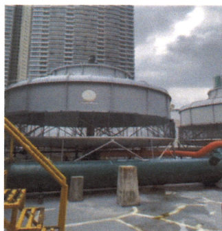
水冷式空調設備
